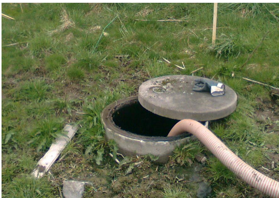
Tett tank som har rent over, og hvor eier tømmer selv. Foto:SSIØ
